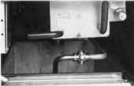
VÁLVULAS FECHADAS (FRITADEIRA ELÉCTRICA)
