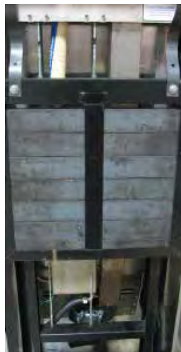
Visualização dos contrapesos com a cobertura removida
