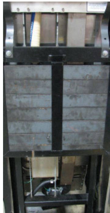
Bekijk de tegengewichten met het deksel verwijderd
