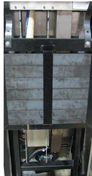
Vista di contrappesi con il coperchio rimosso
