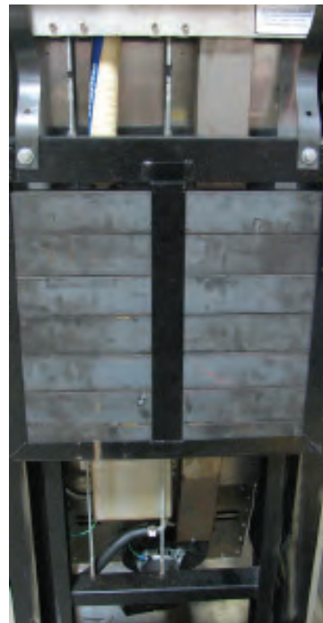
Vista dei contrappesi con coperchio rimosso
