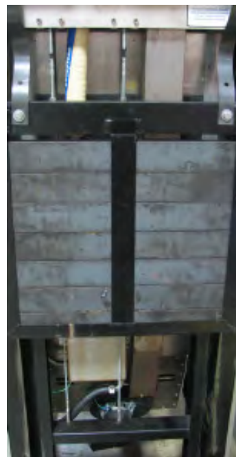
Vista dei contrappesi con coperchio rimosso
